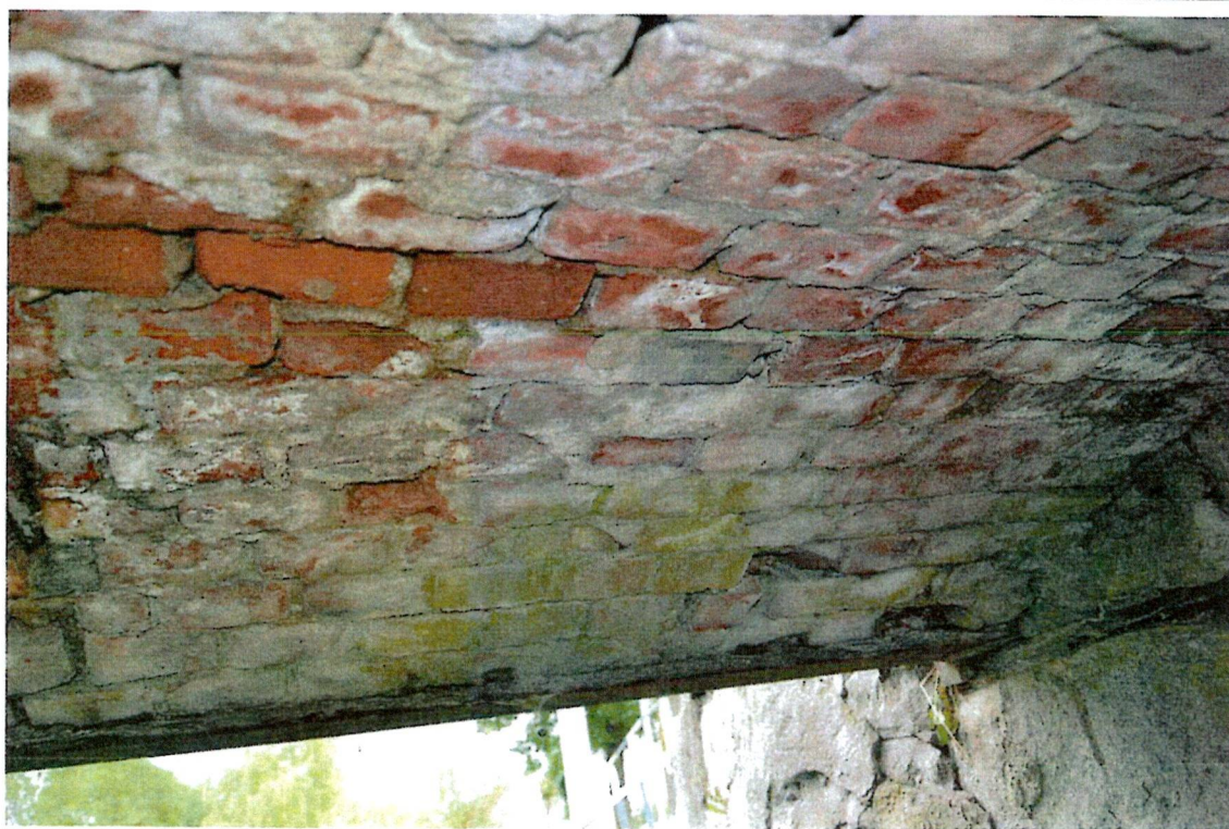
Fot. 10. Widok fragmentu sklepienia ceglanego. Widoczne ubytki i korozja cegieł oraz ślady przecieków wody.
