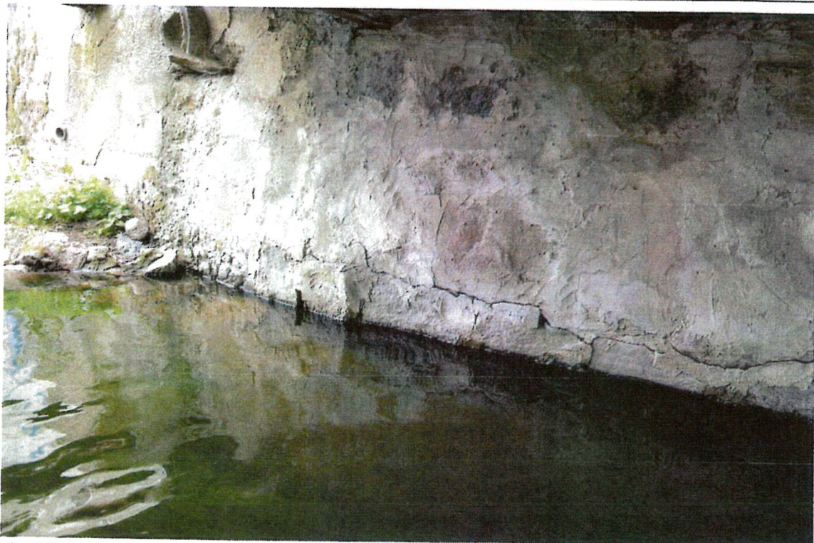
Fot. 8. Widok przyczółka prawobrzeżnego. Widoczne zarysowania w liniach spoin oraz deformacje muru.
