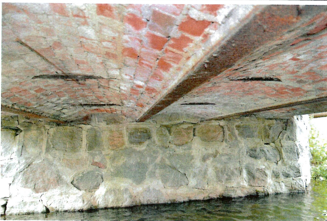
Fot. 6. Widok spodu przęsła części zasadniczej oraz ściany przyczółka prawobrzeżnego. Widoczne zarysowania w liniach spoin i deformacje muru przyczółka oraz korozja elementów stalowych przęsła.
