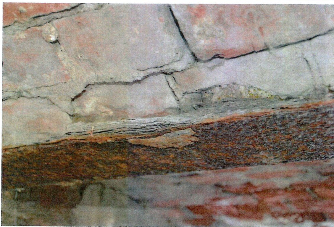
Fot. 9. Widok korozji łuszczącej dolnej półki dźwigara dwuteowego.
