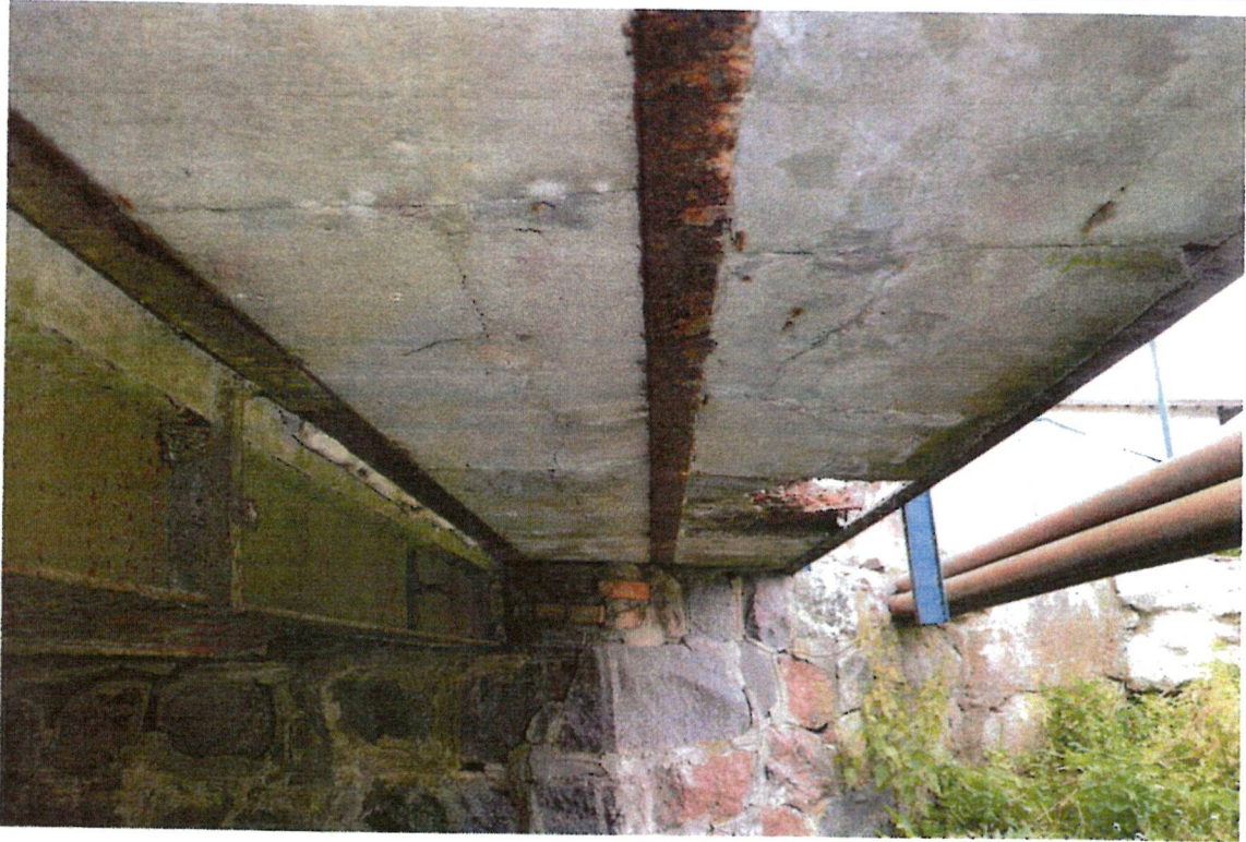
Fot. 7. Widok spodu przęsła części podchodnikowej od strony odpływu. Widoczne zarysowania i ubytek wypełnienia ceglano-betonowego oraz korozja dźwigarów.
