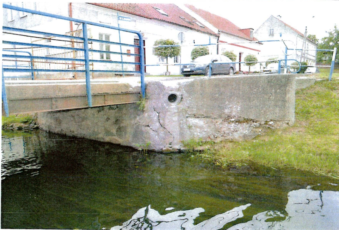
Fot. 5. Skrzydło przyczółka lewobrzeżnego i schody od strony odpływu. Widoczne korozja, zarysowania i ubytki betonu oraz wegetacja roślinna.
