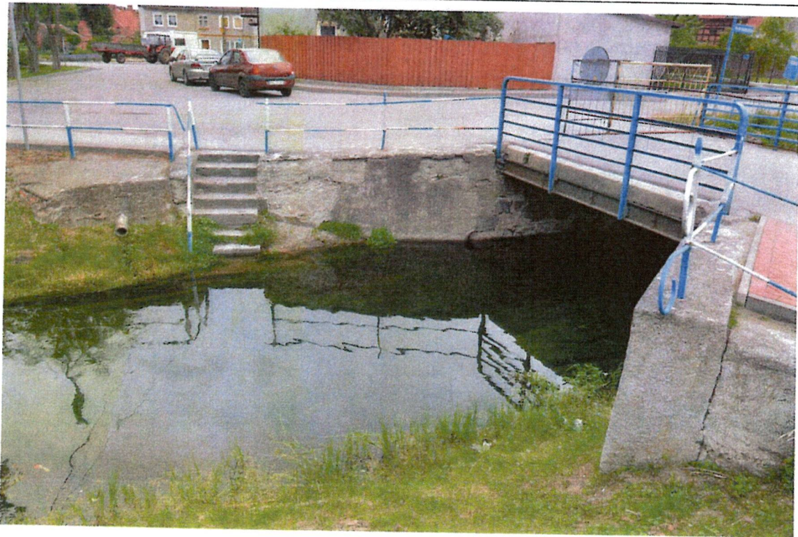
Fot. 4. Skrzydło przyczółka prawobrzeżnego i schody skarpowe od strony odpływu. Widoczna korozja i ubytki betonu oraz wegetacja roślinna.
