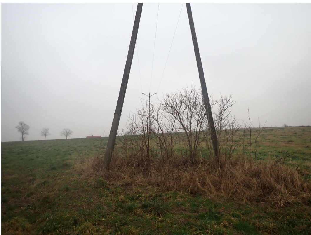
Zdj.9. Widok na obszar opracowania część centralna i północna – linia średniego napięcia.
